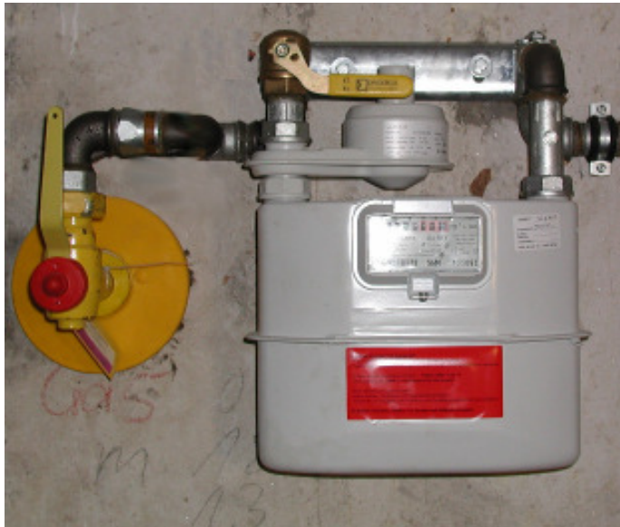
Einzelspartenanschluss mit Gaszähler und Zählerregler
